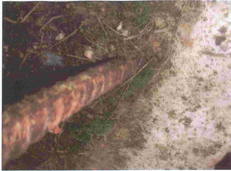
Fot.5. WIDOK KOROZJI ZBROJENIA STROPU
